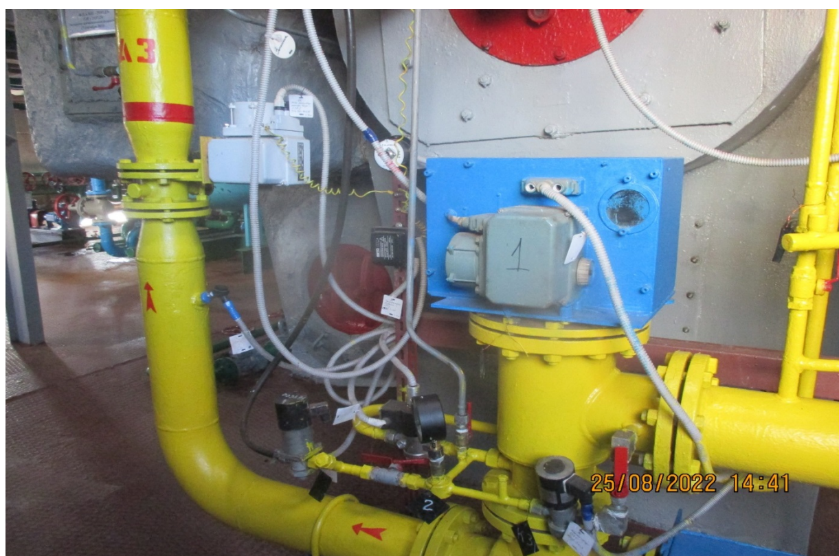
Рисунок 7. Внешний вид котлоагрегата котельной №1
