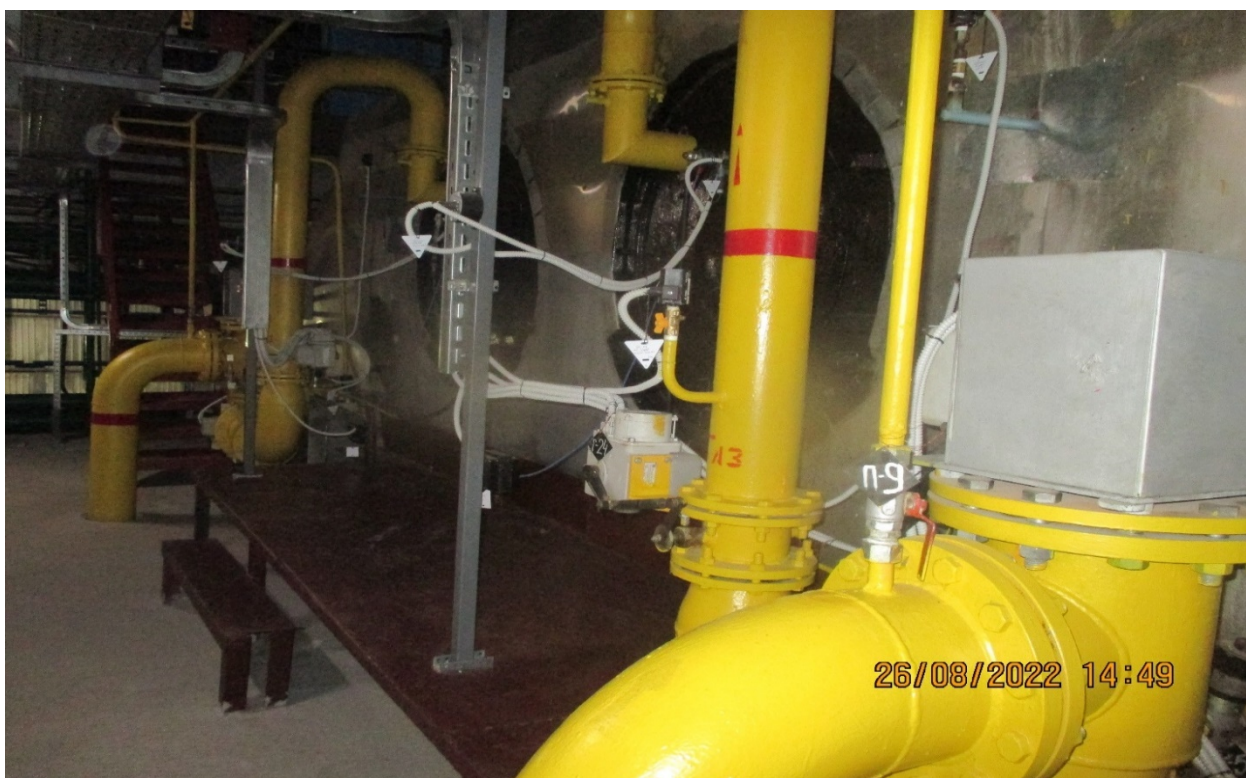
Рисунок 9. Внешний вид котлоагрегатов в котельной №3
