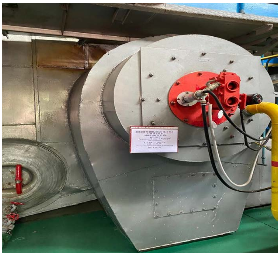
Рисунок 8. Внешний вид котла №1 котельной №2
